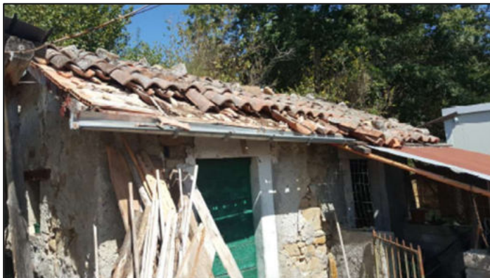
Annesso sub 2 foto post terremoto ante demolizione
