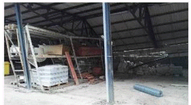
Vista interna edificio danneggiato
