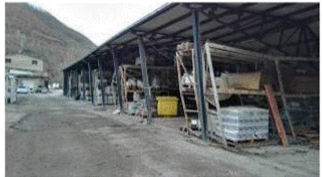
Vista esterna edificio danneggiato
