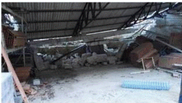
na edificio danneggiato
