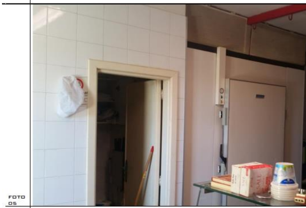
Vista interna edificio danneggiato – Foto 5
