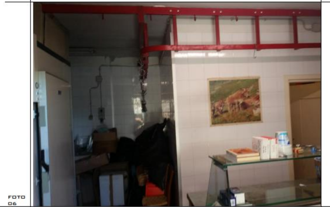
Vista interna edificio danneggiato – Foto 6
